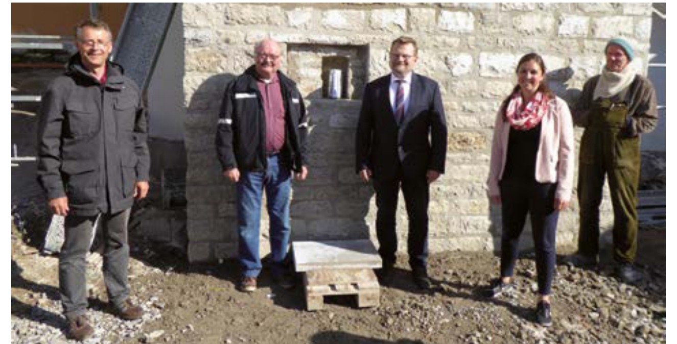
Von links nach rechts: Reiner Váth, Vorsitzender der Teilnehmergeinschaft, Oswald Bader, örtlicher Beauftragter der Teilnehmergeinschaft, Bürgermeister Dr. Werner Knaier, Regina Huller vom Ingenieurbüro Brändlein und Bildhauer Jürgen Schulz beim Einsetzen der Tafel zum Gedenken an die Dorferneuerung am 29.04.2020.
