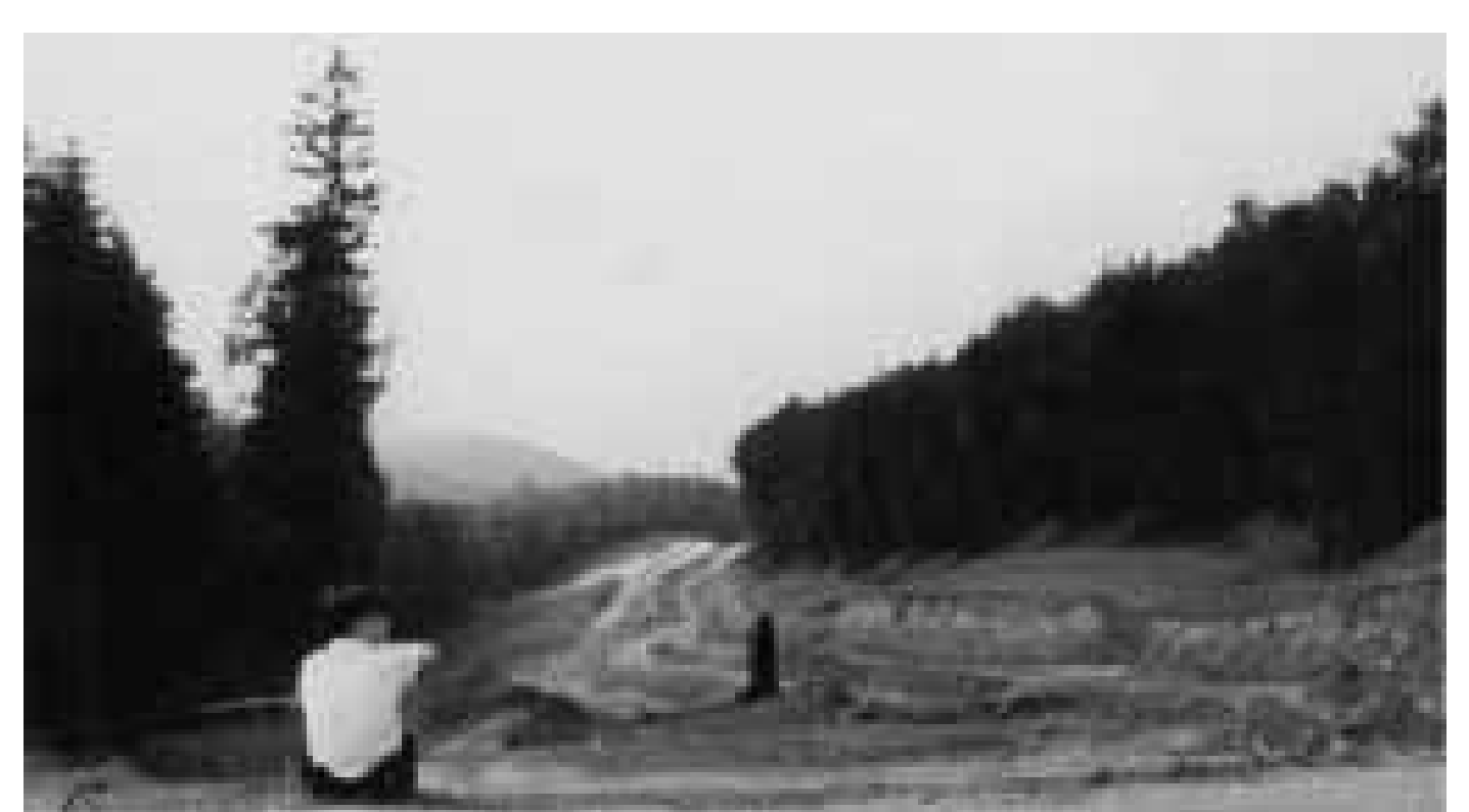
Bauarbeiten am Spessartaufstieg der Autobahn A 3 in der zweiten Hälfte der 1950er Jahre
