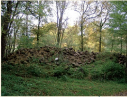
Wenige Meter nach der Schranke am Steinbruch ist rechter Hand der größte Teil vom Bauschutt des alten Gefängnisses gelagert.
