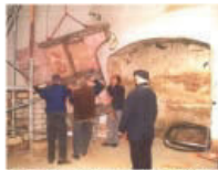
Die Renovierung der Kirche wäre ohne die ehrenamtlichen Helfer nicht möglich gewesen.
