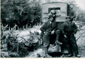
Für die Rodung des Flugfeldes wurden Feldbahnen eingesetzt, wie auf dem Foto von 1938 zu sehen.
