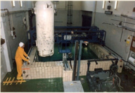
Einblick in die Anlage des VAK Kahl.
