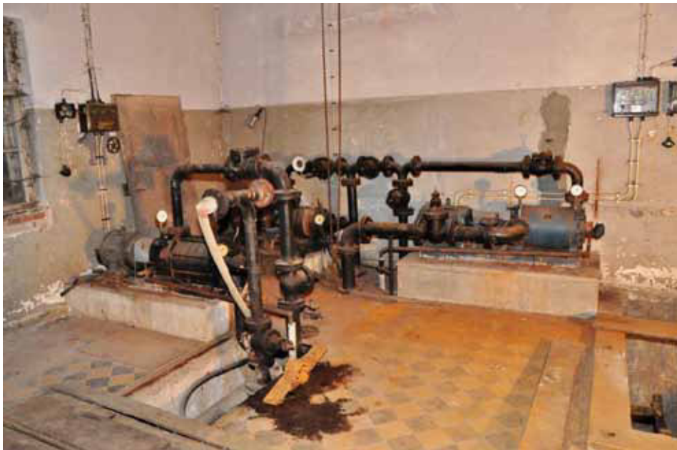
Das Original-Pumpwerk von 1914 ist noch vorhanden
