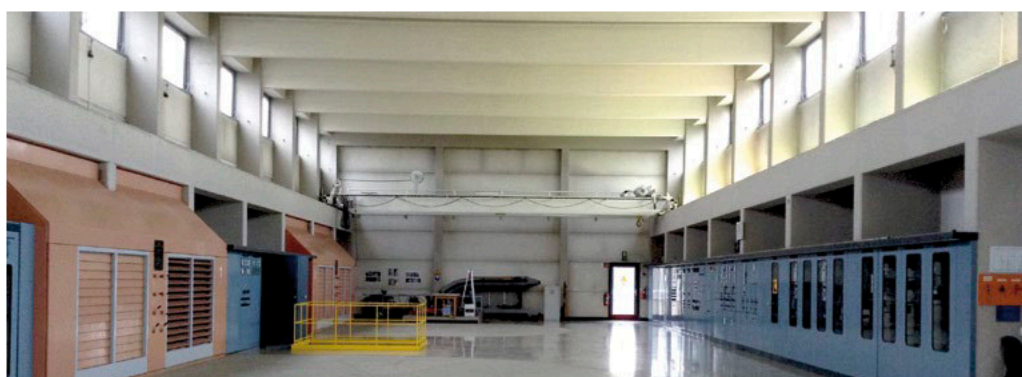
Maschinenhalle des Kraftwerks
