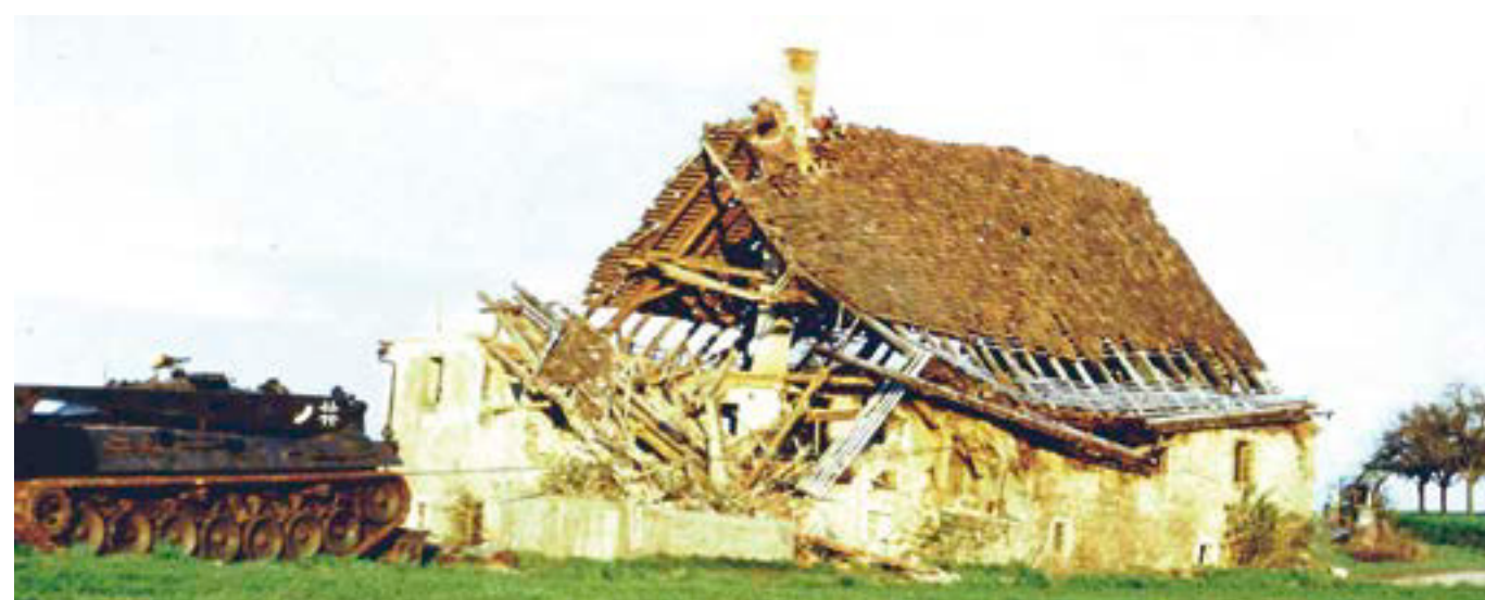
Im Rahmen einer Übung der damals in der Niederstetten stationierten 12. Einheit des 3. Instandsetzungsbataillons der Bundeswehr wurden die Gebäude der Kraftmühle abgetragen.
