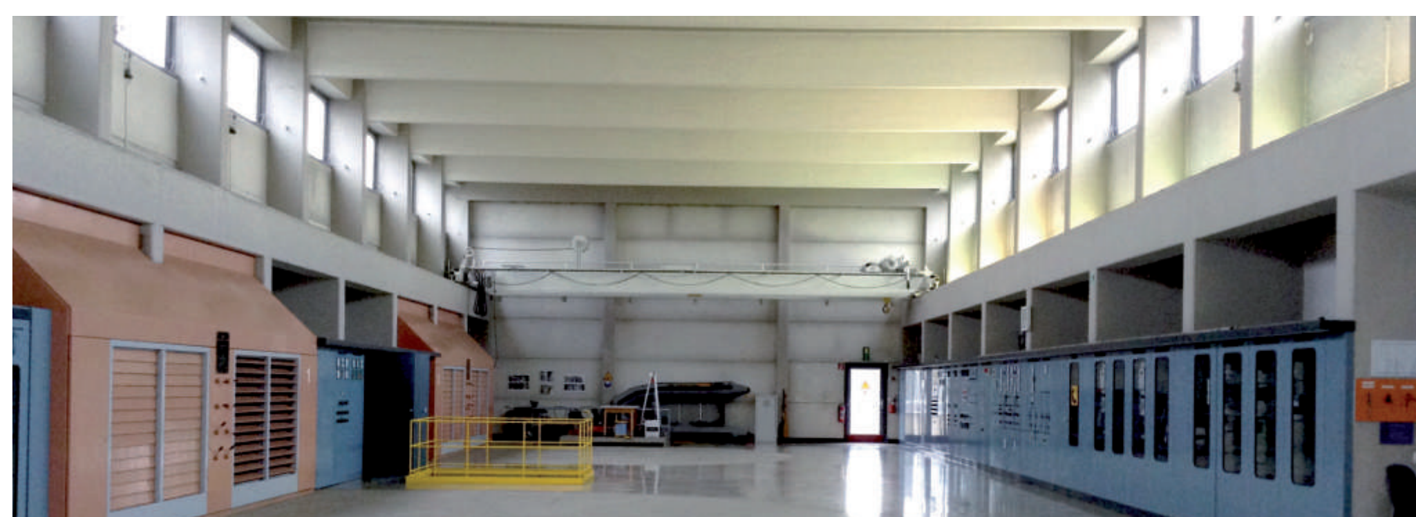
Maschinenhalle des Kraftwerks
