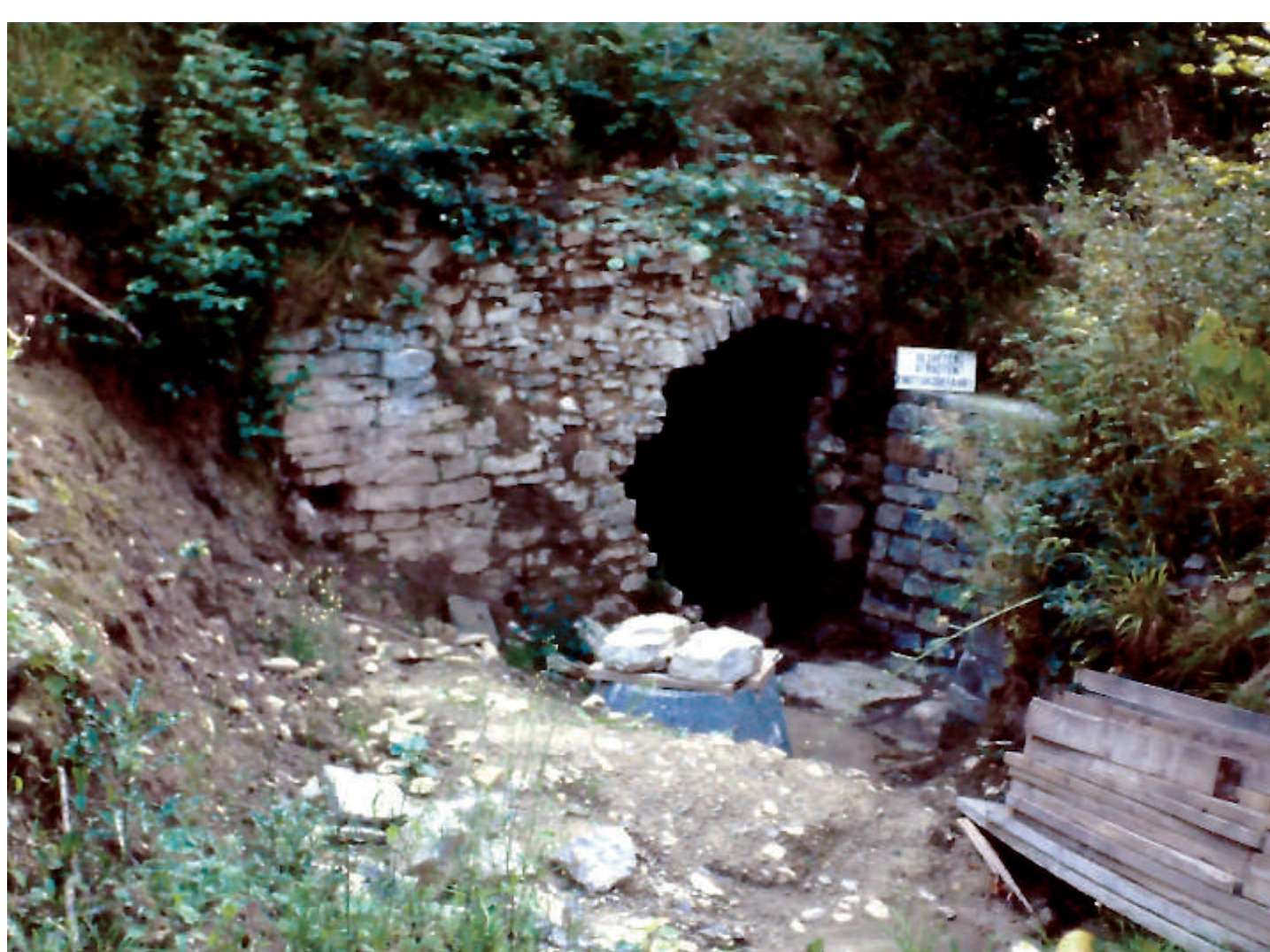
Zustand des Kaltenbrunn zu Beginn der Sanierungsarbeiten.
